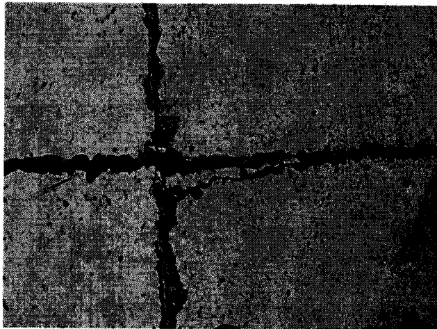
Fotografía N° 7: Grieta en km. 0,583 de calle Amancaes.
